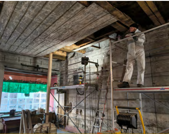
Ein Blick in die Baustelle: Als erstes wurden die Deckenbalken der Torhalle von 1358 saniert. Foto: Birgit Kata, Kempten
